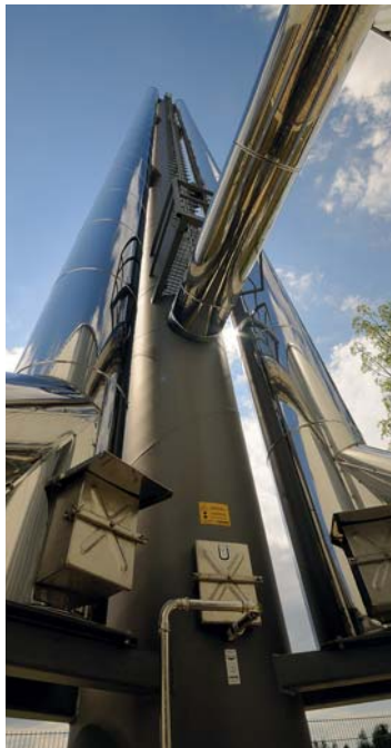
Am Standort Ladenburg erzeugt ABB mit einem BHKW Wärme und Strom für den Eigenbedarf.
