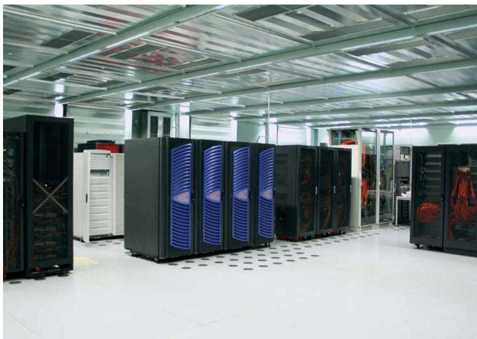
Serverflächen im Höchstleistungsrechenzentrum Stuttgart (HLRS) der Universität Stuttgart.
