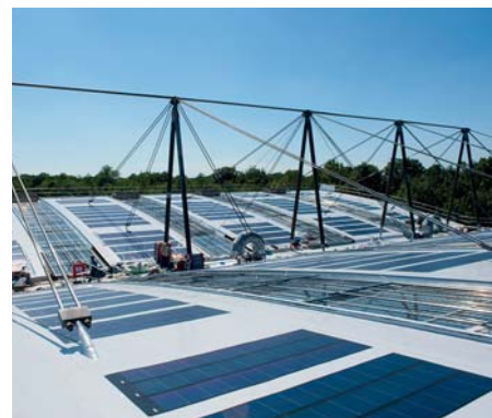
Rund ein Drittel der Dachfläche von insgesamt 5.026 m 2 bedecken die Dachbahnen mit integrierten PV-Modulen. Die Anlage erreicht eine Gesamtleistung von 78,34 kWp.
